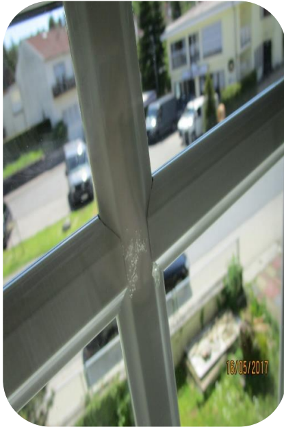
Klimalasten haben Sprossenschutz zerstört
